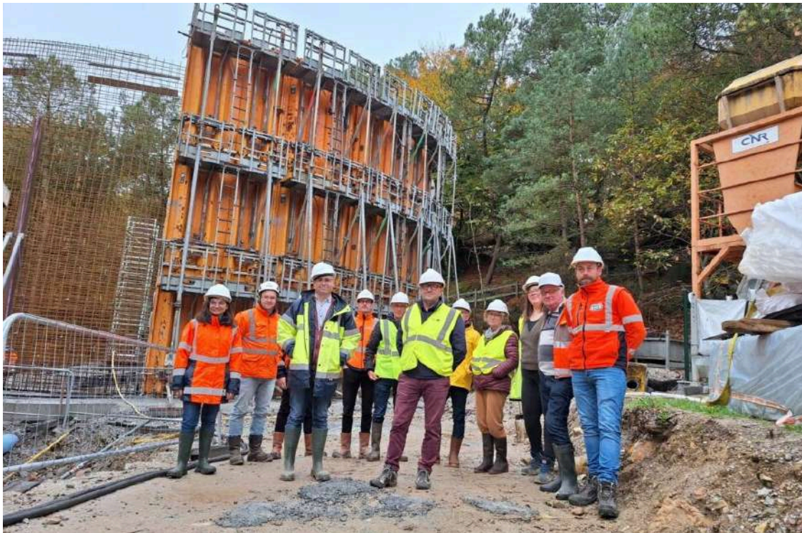
Le second réservoir de Cléguérec (Morbihan), destiné à desservir en eau potable les abonnés de Pontivy Communauté, aura une capacité identique au premier, soit 2 000 m3. Un ouvrage de 20,5 mètres de diamètre et 7 mètres de haut, nécessitant 300 tonnes d'acier et 400 m3 de béton. Livraison prévue en avril 2026. ©Pontivy Journal
